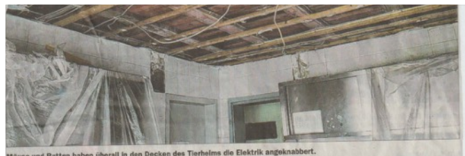
Mäuse und Ratten haben überall in den Decken des Tierheims die Elektrik angeknabbert.
